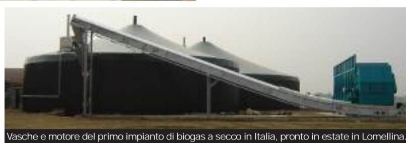
Vasche e motore del primo impianto di biogas a secco in Italia, pronto in estate in Lomellina.
