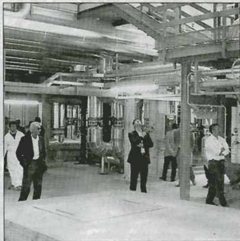
L'interno della centrale di teleriscaldamento a Tirano (Cdg)
