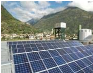
Impianto fotovoltaico a Tirano
