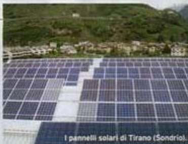
I pannelli solari di Tirano (Sondrio).
