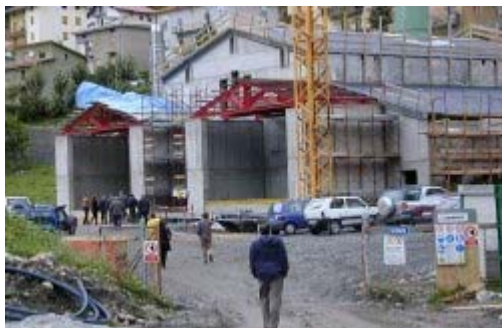
momento della visita alla centrale di Sondalo
